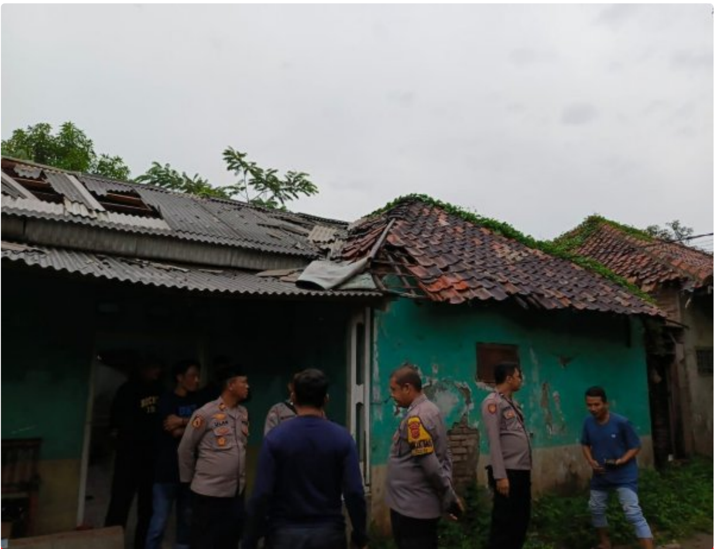
Kapolsek Rawamerta meninjau langsung rumah warga yang rusak akibat angin dan hujan lebat di desa Panyingkiran
